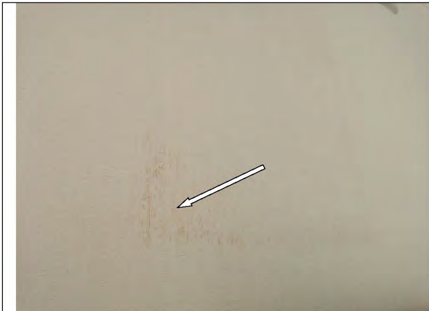
Фото №16. Загрязнение обойного полотна в кухне.
