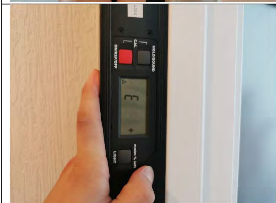
Фото №53. Отклонение коробки деревянного дверного блока от уровня вертикальности в кухне.
