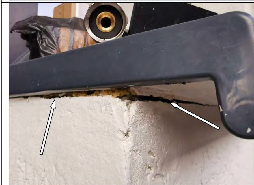
Фото №47. Отверстие под подоконником на лоджии не загерметизировано.
