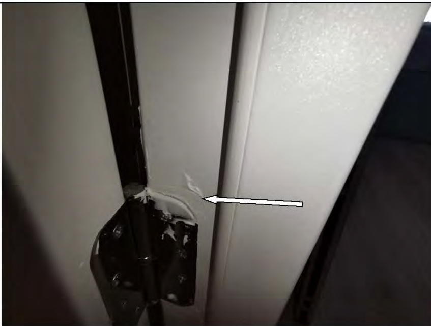
Фото №56. Загрязнение коробки деревянного дверного блока в спальне.
