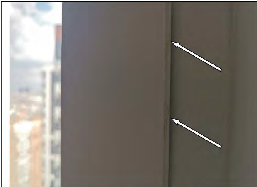
Фото №43. Загрязнение профиля ПВХ оконного блока в кухне.
