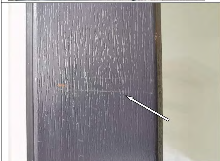
Фото №41. Царапины на профиле ПВХ дверного блока в спальне.
