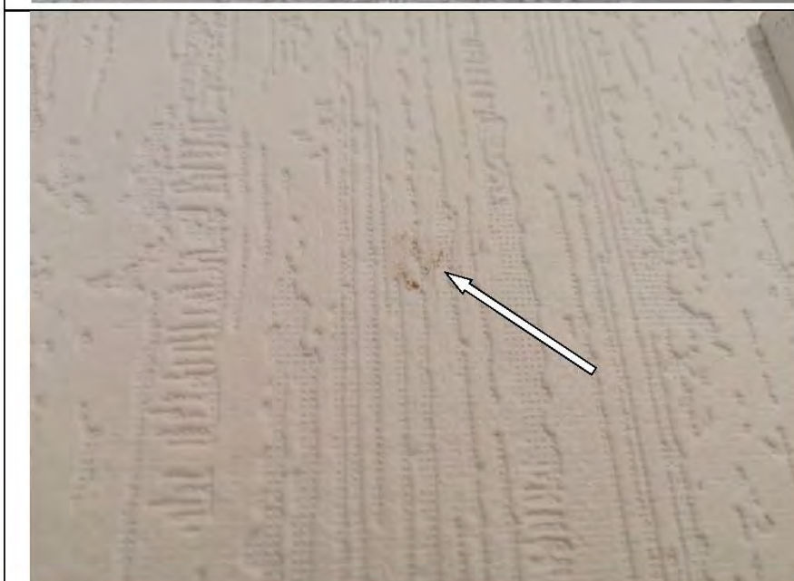
Фото №12. Загрязнение обойного полотна в коридоре.
