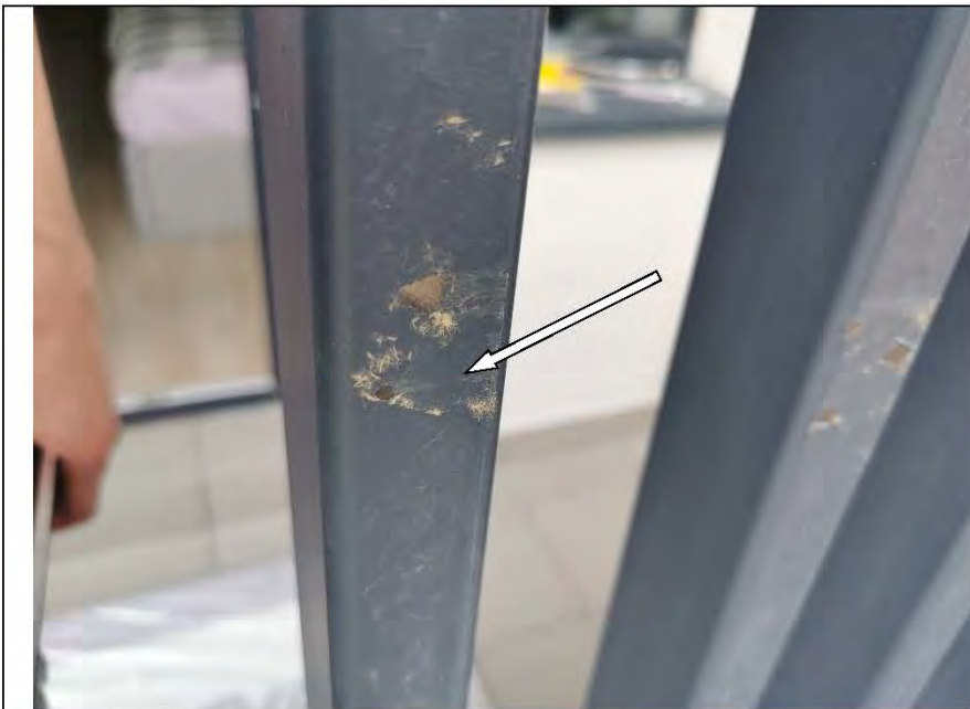
Фото №64. Коррозия на металлических ограждениях на лоджии.
