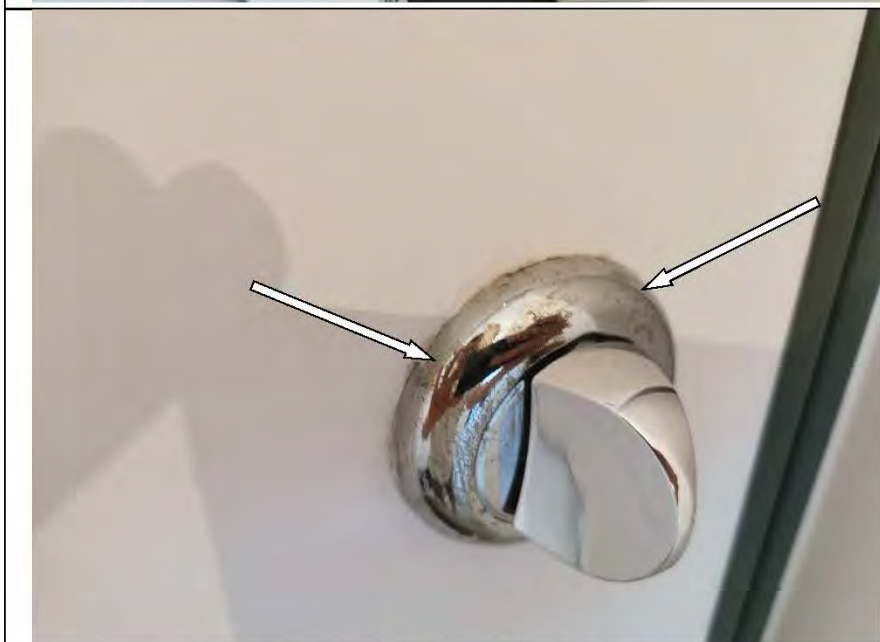
Фото №62. Загрязнения на фурнитуре входного дверного блока.
