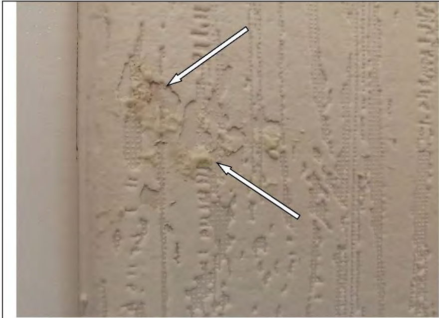
Фото №13. Загрязнение обойного полотна в коридоре.
