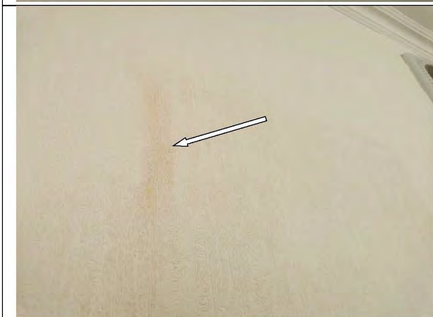
Фото №17. Загрязнение обойного полотна в кухне.
