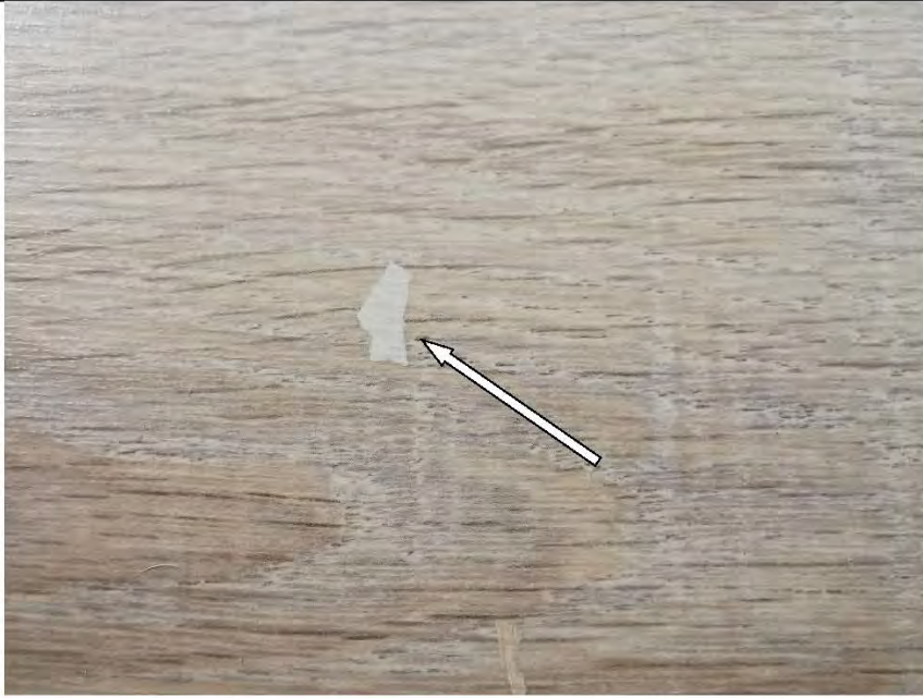
Фото №22. Загрязнения на поверхности ламината в спальне.
