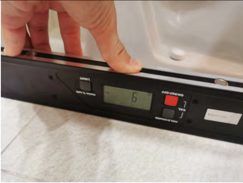
Фото №25. Измерение уровня пола в ванной комнате. Отклонение составляет 6 мм.
