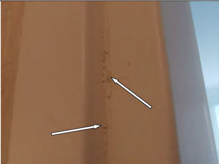
Фото №59. Загрязнение коробки деревянного дверного блока в кухне.
