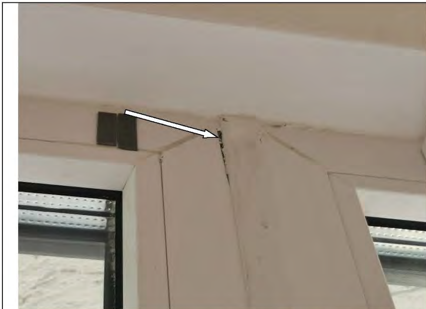
Фото №37. Щели в месте соединения оконного и дверного блока ПВХ в спальне.
