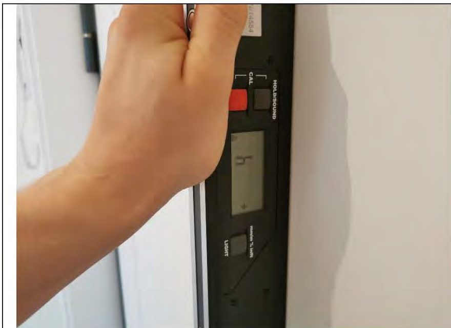
Фото №61. Отклонение полотна входного дверного блока от плоскостности и прямолинейности.
