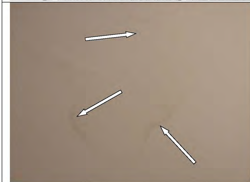
Фото №32. Загрязнения и трещины на поверхности окрашенного потолка в коридоре.
