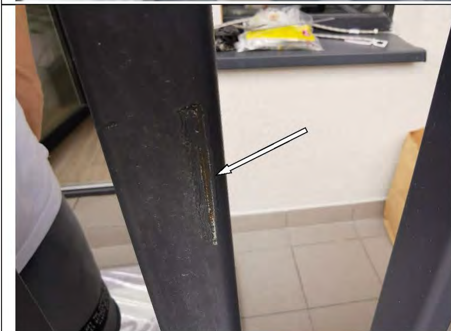
Фото №65. Коррозия на металлических ограждениях на лоджии.
