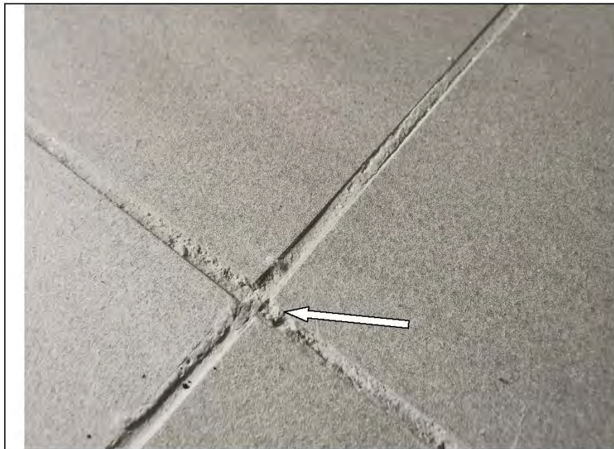
Фото №31. Неполное заполнение шовного пространства напольной керамической плитки затирочным составом в кухне.
