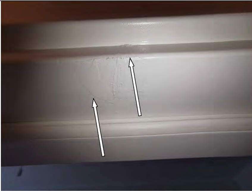
Фото №55. Загрязнение коробки деревянного дверного блока в спальне.
