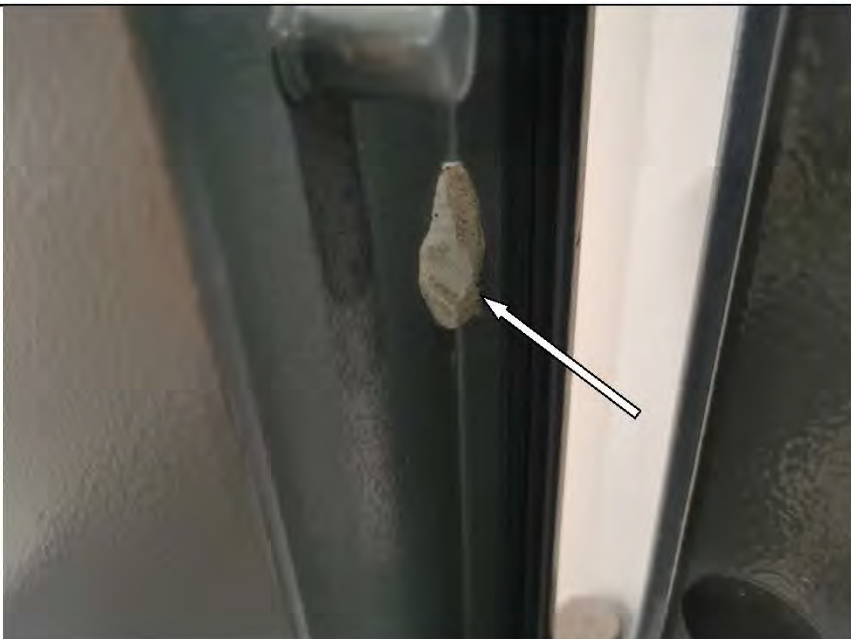
Фото №60. Загрязнение коробки входного дверного блока.
