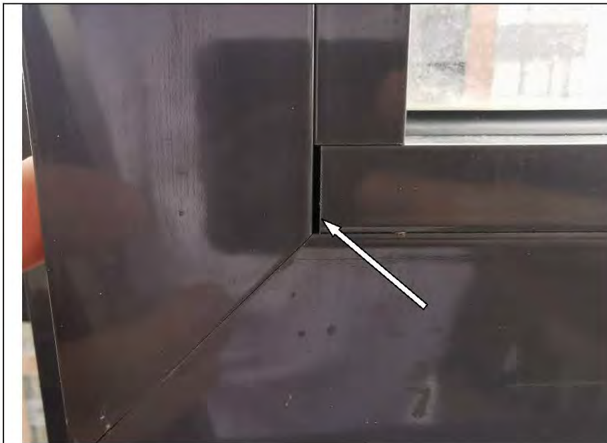
Фото №49. Зазор в месте соединения профилей металлического оконного блока на лоджии.
