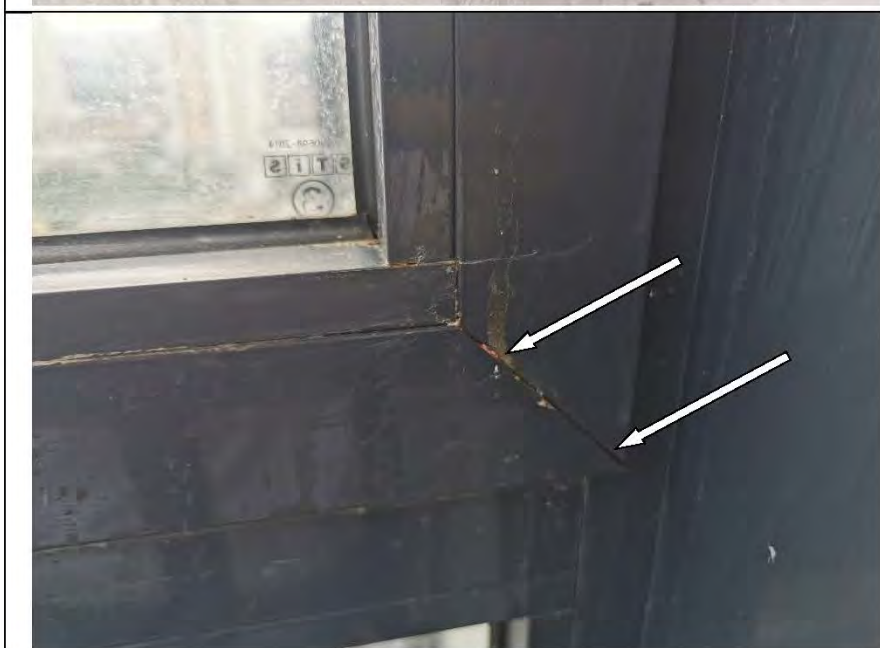
Фото №48. Зазор в месте соединения профилей металлического оконного блока на лоджии.
