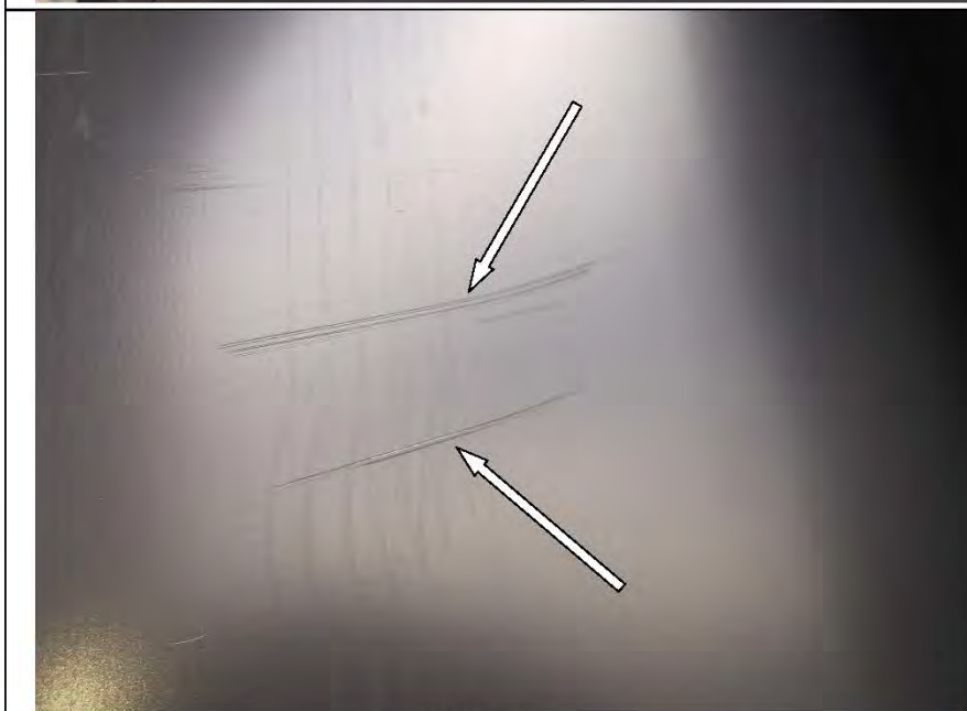
Фото №50. Царапины на металлическом профиле оконного блока на лоджии.
