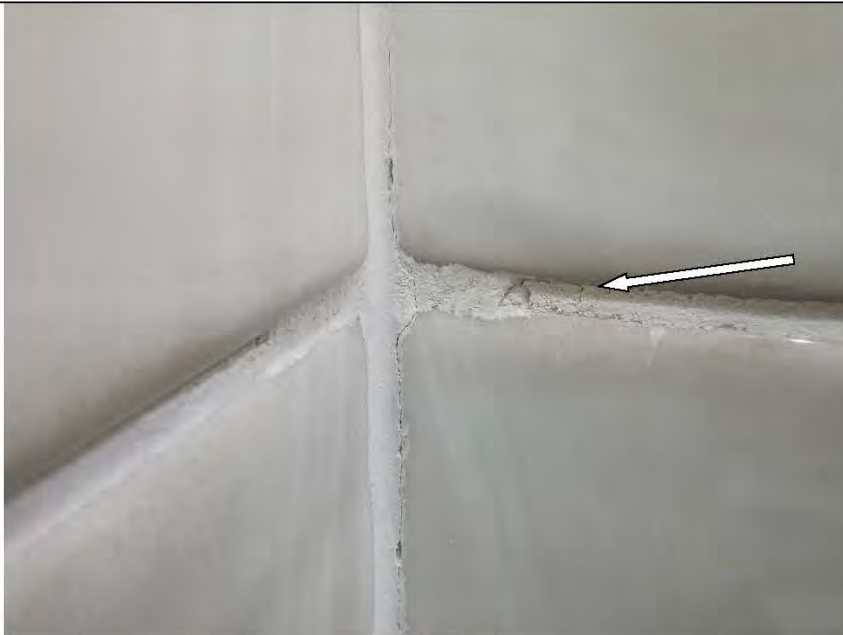
Фото №19. Неравномерное заполнение шва настенной плитки затирочным составом в ванной комнате.
