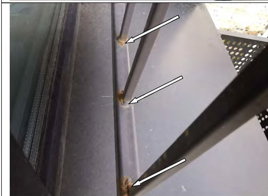
Фото №63. Коррозия на металлических ограждениях на кухне.
