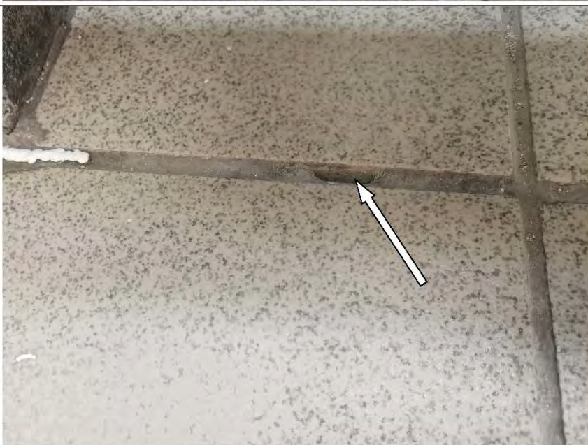
Фото №29. Неполное заполнение шовного пространства напольной керамической плитки затирочным составом на лоджии.
