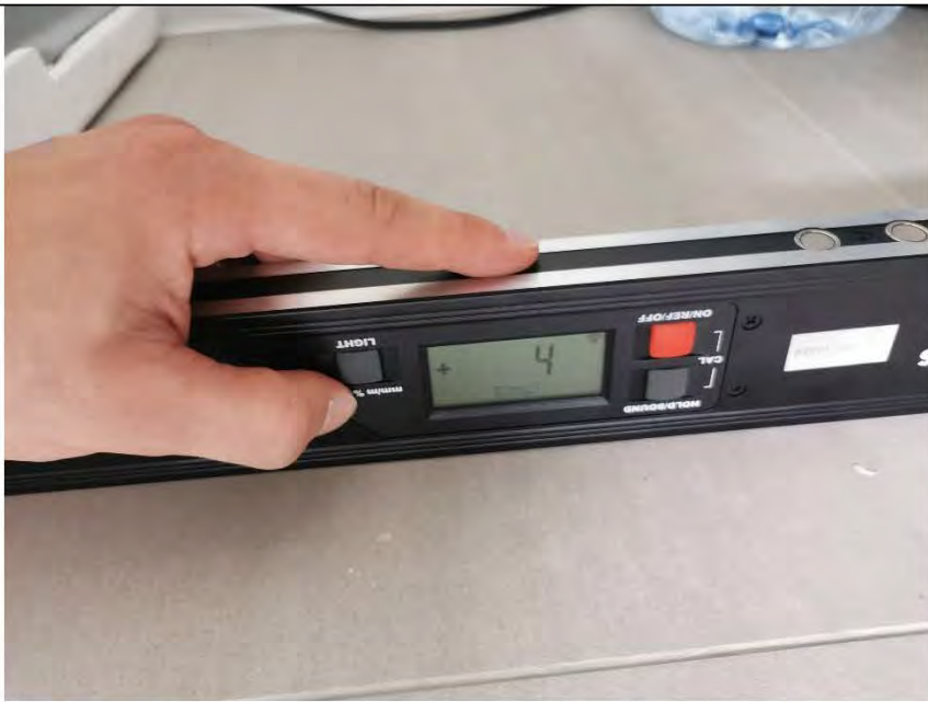
Фото №26. Измерение уровня пола в кухне. Отклонение составляет 4 мм.
