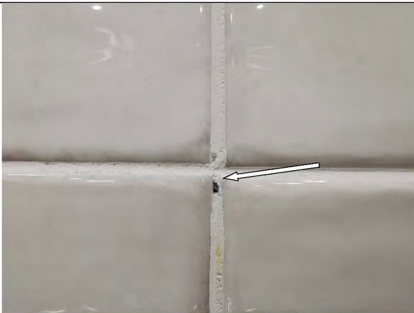
Фото №20. Неравномерное заполнение шва настенной плитки затирочным составом в ванной комнате.
